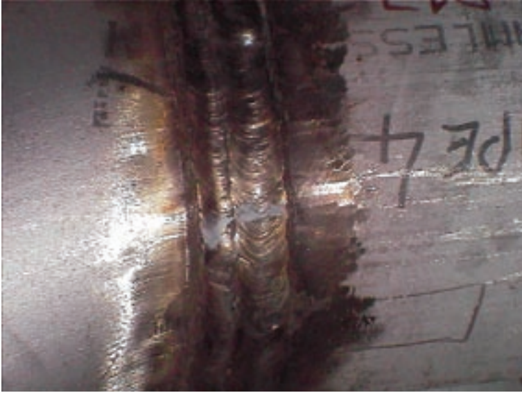
Kaynakla birleştirilmiş parçanın yüzey işlemi yapılmamış görünümü : Temizlenmemiş kaynak kabuğunun korozyona neden olması kaçınılmazdır.
