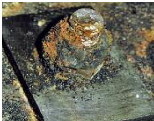
Figuur 14: Galvanische corrosie van de roestvast stalen ankerbouten van een filterbekken bij een waterbehandelingsinstallatie, waarbij actieve kool gebruikt wordt: samengebouwde (boven) en losgemaakte (onder) ankerbout uit 1.4016 roestvast staal. De onderste foto toont hoe de doorsnede van de bout verminderd is door corrosie.
