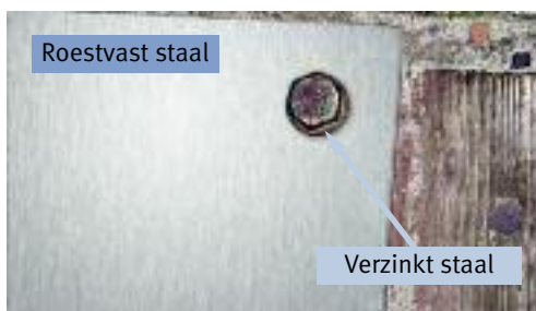
Figuur 10a, 10b: Praktische voorbeelden van het principe getoond in Figuur 9 (verzinkt staal in contact met roestvast staal, in een zee atmosfeer)
