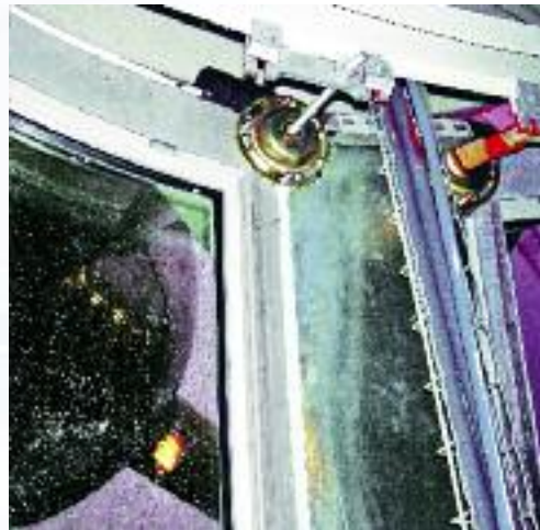
Figuur 19: Om galvanische corrosie te voorkomen is de roest- vast stalen plaat beves- tigd aan de stalen binnenstructuur in droge ruimtes.
