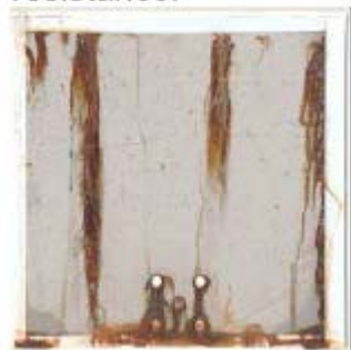
胶带粘接不良会引起腐蚀。
