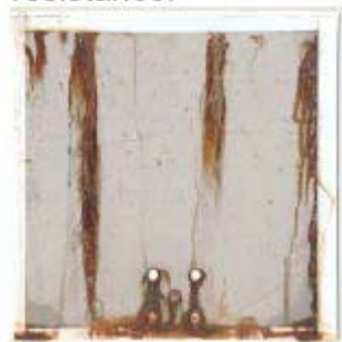
胶带粘接不良会引起腐蚀。
