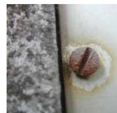
Spojovací prostředky z nekorozivzdorné oceli jsou napadány rychlou a silnou korozí.
