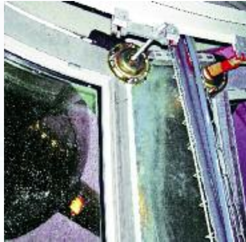
Şekil 19: Galvanik korozyonu önlemek amacıyla, pas- lanmaz çelik kaplama, karbon çeliği iç iskelete nem bulunmayan alan- larda bağlanmıştır.
