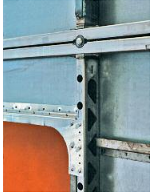
Şekil 23: Bir banliyö trenine ait bu yan duvarda iskelet ve dış paneller farklı kalitede paslanmaz çeliktendir. Bunlar özdeş potansiyele sahip olduklarından, gal- vanik korozyon meydana gelmemektedir.
