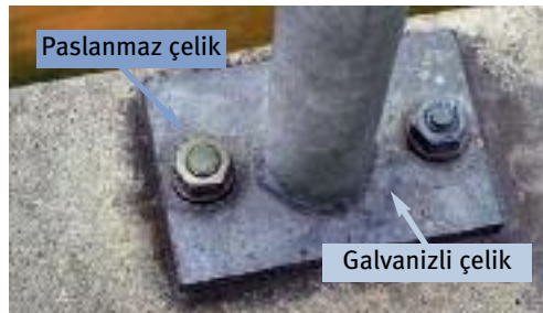
Şekil 8a, 8b: Çok büyük galvanizli çelik parçalar üzerindeki paslanmaz çelik bağlantı elemanları, normalde korozyona sebep olmazlar.
