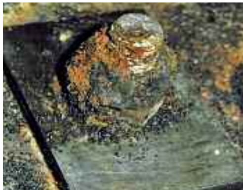
Obrázek 14: Galvanická koroze šroubů z korozivzdorné oceli na filtrační nádrži úpravny vody využívající aktivního uhlí: sešroubovaný spoj (vlevo) a kotvící šroub z oceli EN 1.4016 po sejmutí matice s viditelným korozním úbytkem na průřezu (vpravo).
