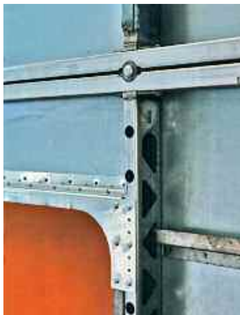
Obrázek 23: Bočnice vagonu příměstské dopravy a její nosná konstrukce jsou z různých značek korozivzdorných ocelí. Jejich potenciál je stejný, takže ke galvanické korozi nedochází.
