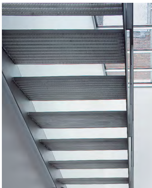
Die Treppen und Handläufe aus nichtrostendem Stahl zeichnen sich durch schlanke Profile und hohe Transparenz aus.
